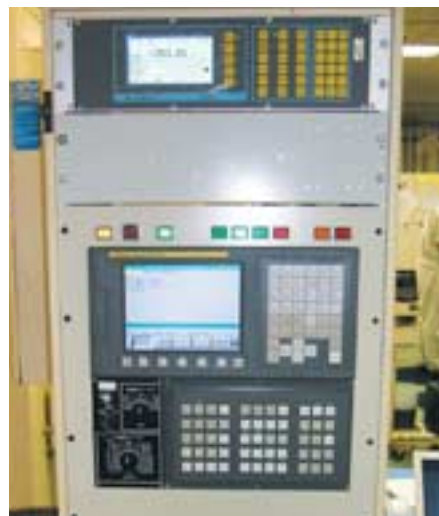
機械操作盤更新後
