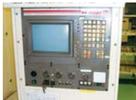
機械操作盤更新前
