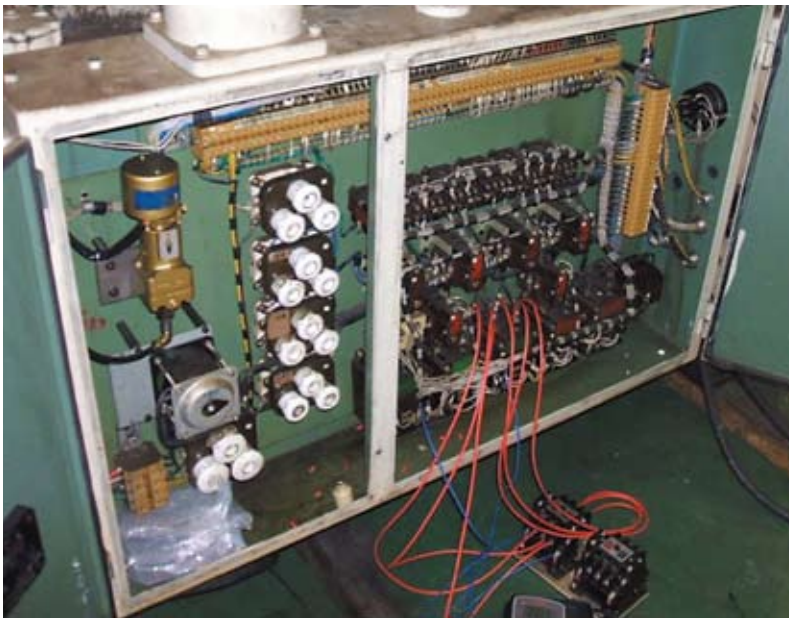
研削盤有接点リレー制御装置
